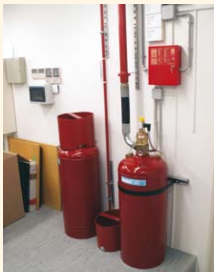
Компоненты системы газового пожаротушения
