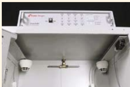
Система стоечного пожаротушения
