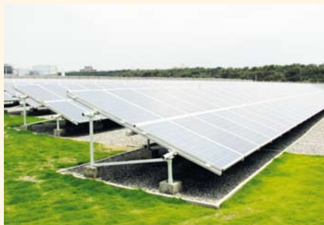
Солнечная электростанция Powercom на Тайване
