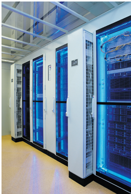
LCP Inline – оптимальное решение для ЦОДа. Охлаждение осуществляется на уровне рядов стоек, расположенных по принципу чередования изолированных холодных и горячих коридоров
