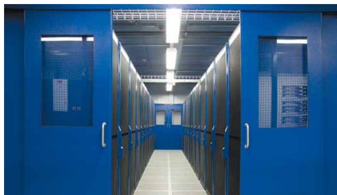
Решение для отделения коридоров представляет собой комбинацию из дверных и потолочных элементов, позволяющих осуществить полное разделение пространств с холодным и теплым воздухом в ЦОДе
