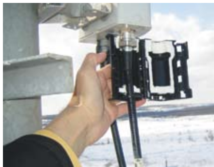
Механическая муфта OSCW-S – для герметизации соединения «джампер–антенна», смонтированная на опытной зоне крупного оператора мобильной связи
