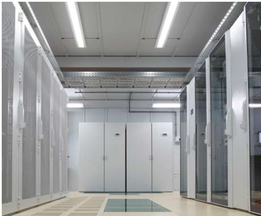
Помещение безопасности Lampertz
