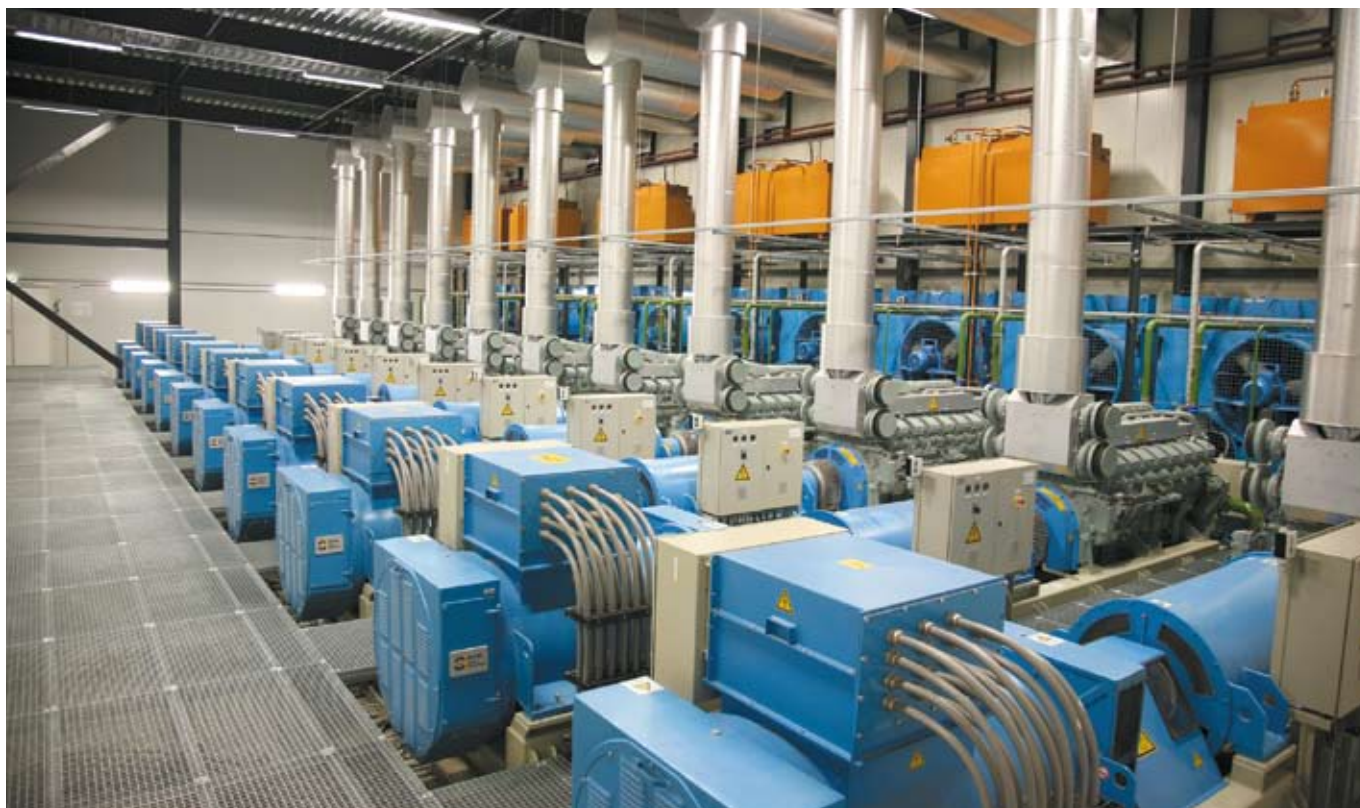
Рис. 2. ЦОД, зал ДР ИБП: На площадке 30 x 20 м построена система бесперебойного гарантированного электроснабжения мощностью 18,4 МВ·А на основе параллельной конфигурации N + 1. В этом ЦОДе два таких зала ДР ИБП.
