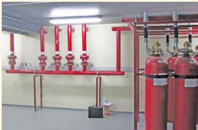
Централизованная установка газового пожаротушения
