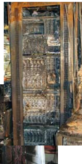
Последствия пожара в центре обработки данных .
