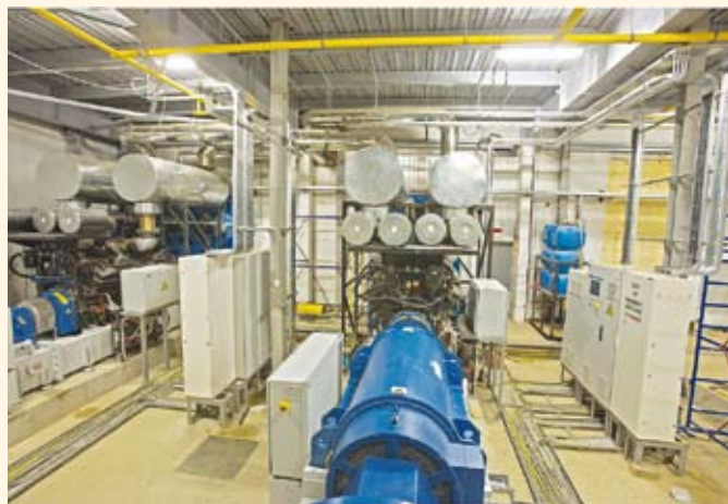
ДИБП первой очереди в ЦОДе «Электронной Москвы»
