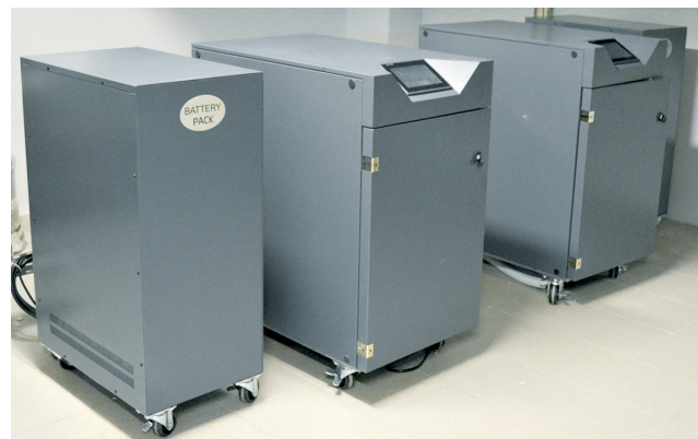
ИБП ONL-33-II общей мощностью 45 кВА для обеспечения бесперебойной работы операционной
