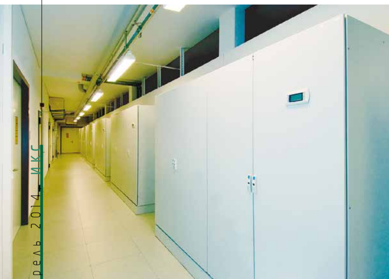
Высокоэффективные, надежные и устойчивые: восемь климатических систем обеспечивают охлаждение в дата-центре компании IGN GmbH
