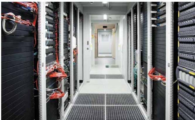
ЦОД RiMatrix S устанавливается на одном из офисных этажей в виде решения «помещение в помещении» на площади около 100 кв. м
