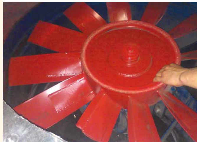
Вытяжной вентилятор со сломанной лопастью
