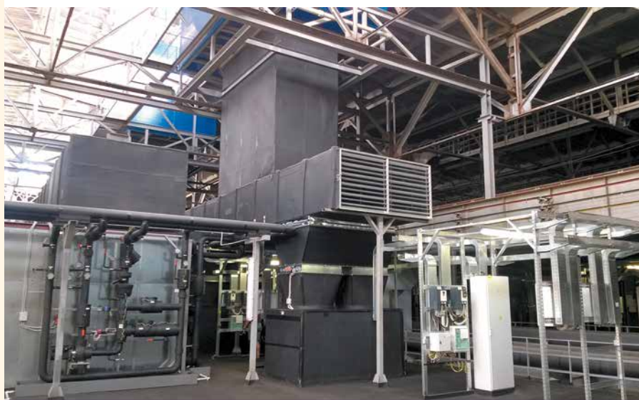
Внешний вид приточно-вытяжных установок с воздуховодами
