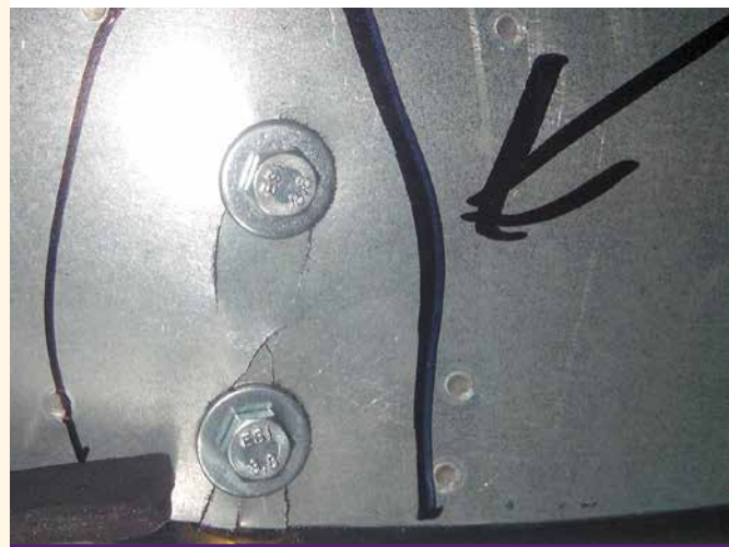
Усталостные трещины на лопастях воздушного клапана вследствие высоких скоростей воздуха
