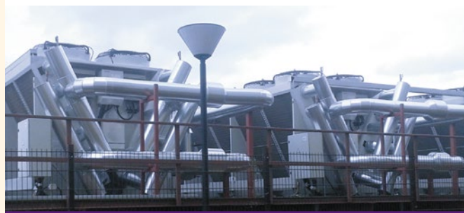
ЦОД с системой водяного охлаждения
