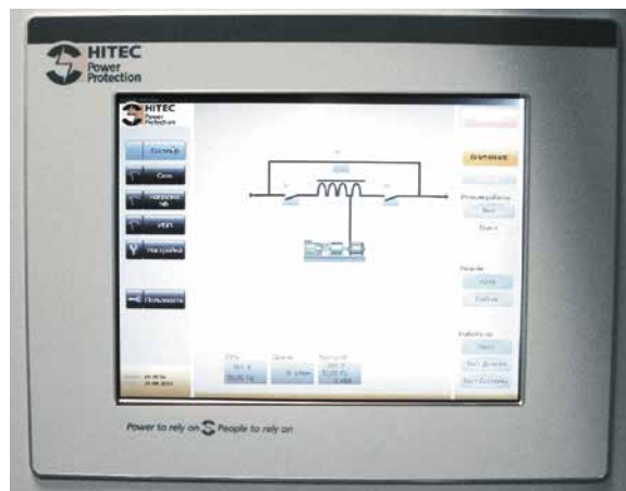
Панель управления ДИБП, установленного в одном из коммерческих ЦОД в Москве
