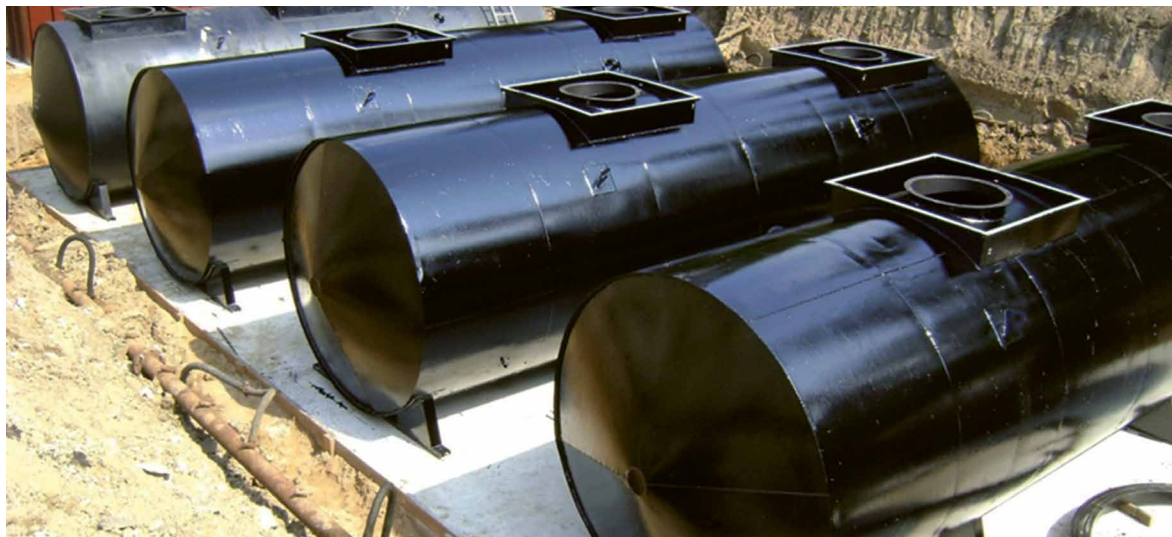
Рис. 1. Резервуары подземного топлиохранилища ▶
