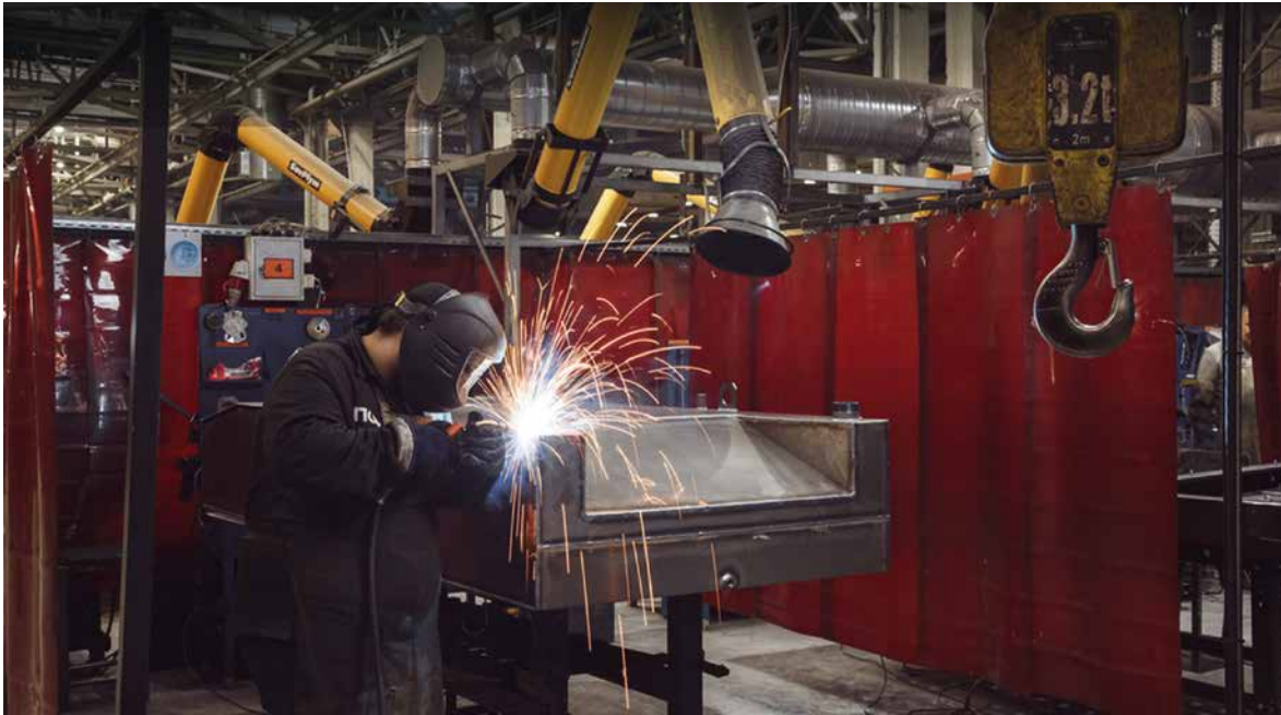
◀ Рис. 5. Завод металлоконструкций ПСМ
